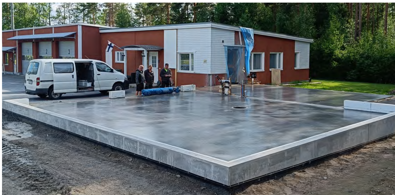
Kuva 1. Terjärv Frivilliga Brandkår r.f.:lle myönnettiin keväällä 2025 paloaseman lisärakennuksen rakentamiseen 84 014 euron avustus. Perustuksia alettiin valamaan pian avustuspäätöksen jälkeen. Hanketta on seurattu myös Ylen dokumenttisarjassa Kylän sankarit, joka kertoo Teerijärven VPK:n arjesta. Kuva: Mats Lindh / Terjärv Frivilliga Brandkår r.f.
